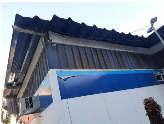
Telhado – telhas soltas (sem terça útil)
