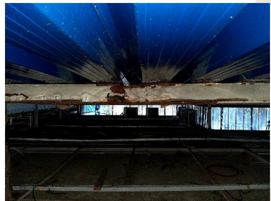
Telhado da UPA terça destruída
