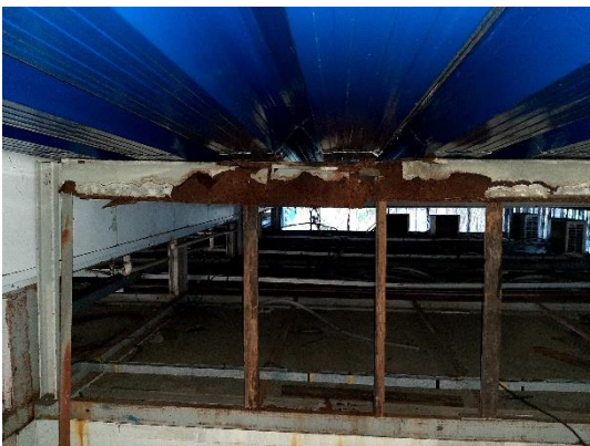
Telhado da UPA terça destruída
