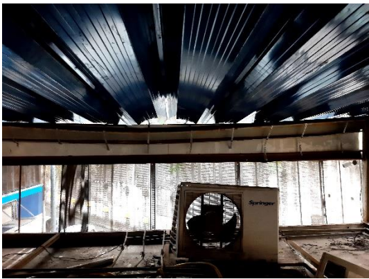
Telhado – telhas soltas (sem terça útil)
