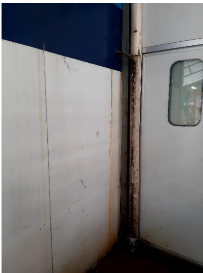
Estrutura da rampa enferrujada
