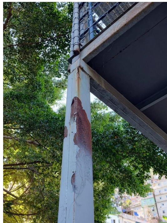
Estrutura da rampa enferrujada
