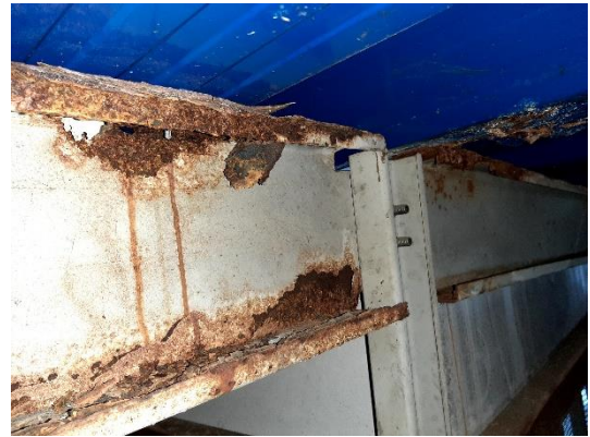
Telhado da UPA terça destruída
