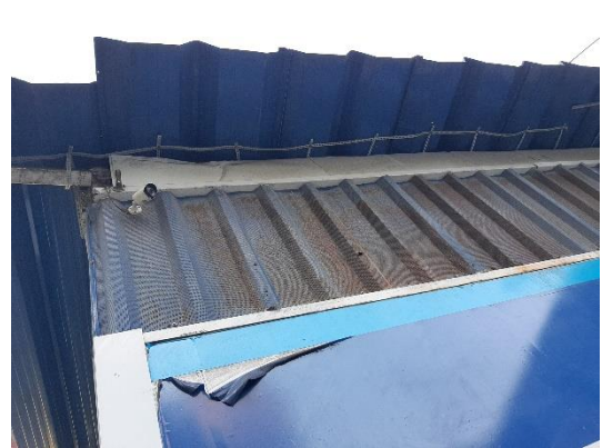
Telhado – telhas soltas (sem terça útil)
