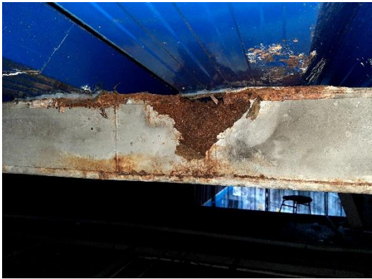
Telhado da UPA terça destruída
