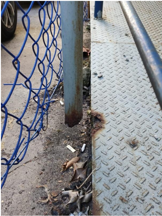
Estrutura da rampa – perda de seção
