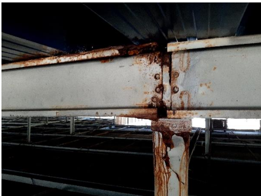
Telhado – estrutura comprometida
