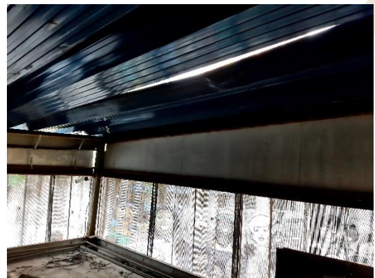
Telhado – telhas soltas (sem terça útil)
