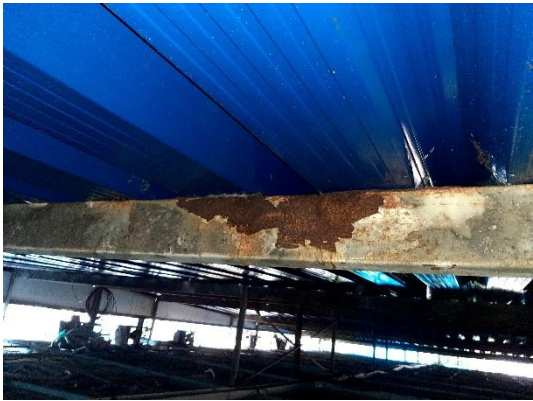
Telhado – telhas soltas (sem terça util)
