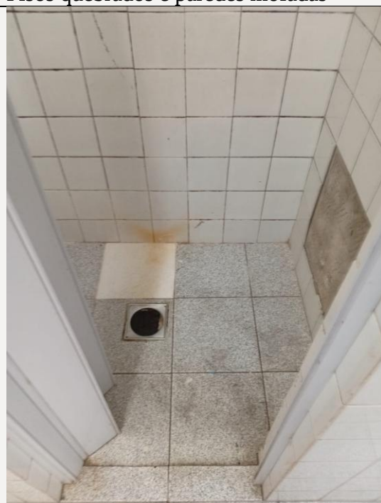
Azulejos quebrados e tampa de ralo faltante
