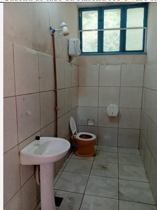
Piso quebrado e tubulação exposta
