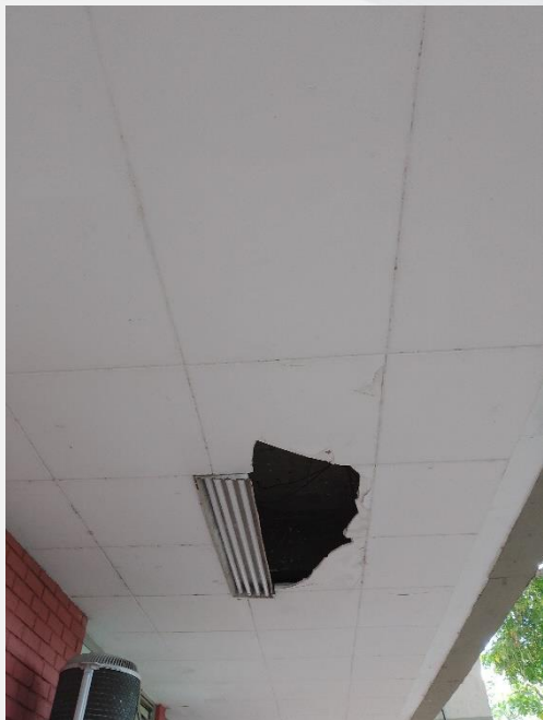
Forro danificado frente da unidade
