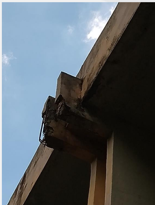
Viga quebrada (frente)
