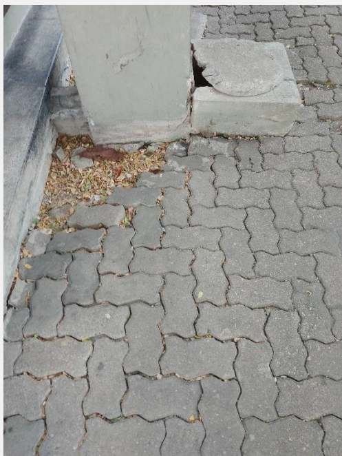
Intertravado afundando por assentamento do solo
