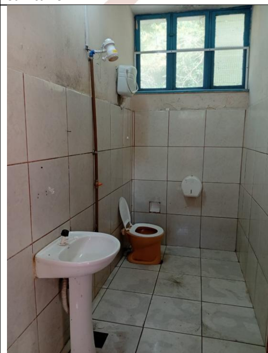
Piso quebrado e tubulação exposta
