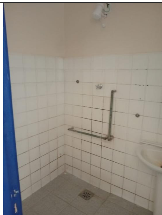
Barras de apoio inadequadas
