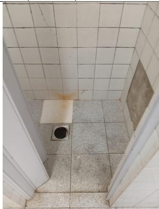
Azulejos quebrados e tampa de ralo faltante
