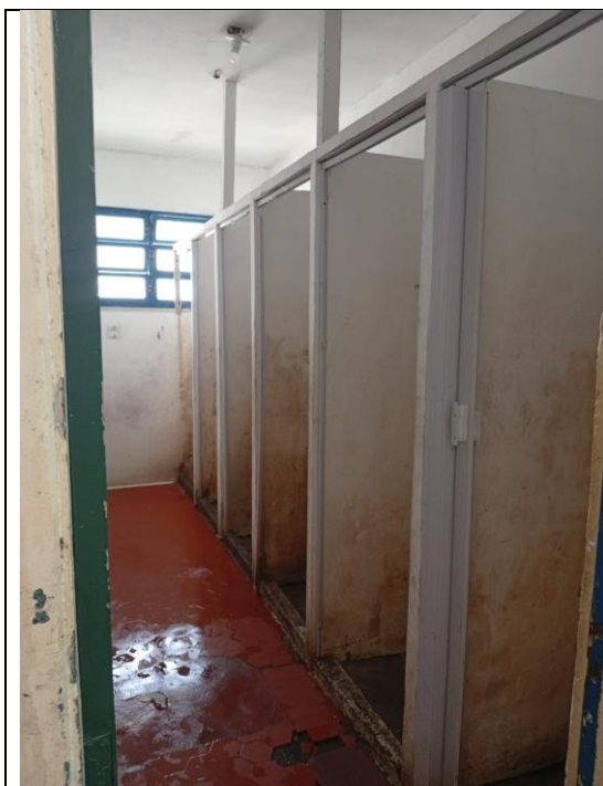
Pisos quebrados e paredes mofadas
